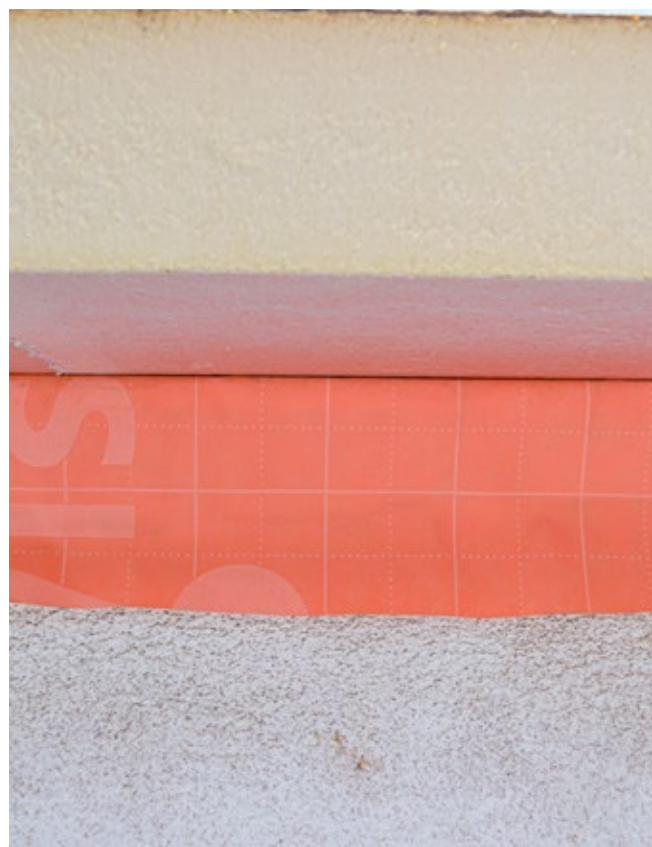
Le pare-vapeur doit être raccordé sous l'isolation de façade (pignon et sous l'avant-toit).
